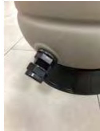
Abb. Kontermutter mit Dichtung und Verschluss vom Filterkessel außen
